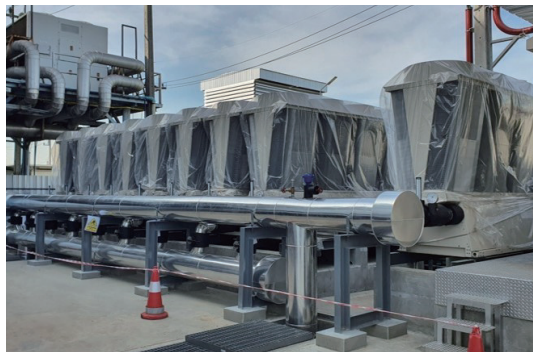
省エネボイラーの導入
